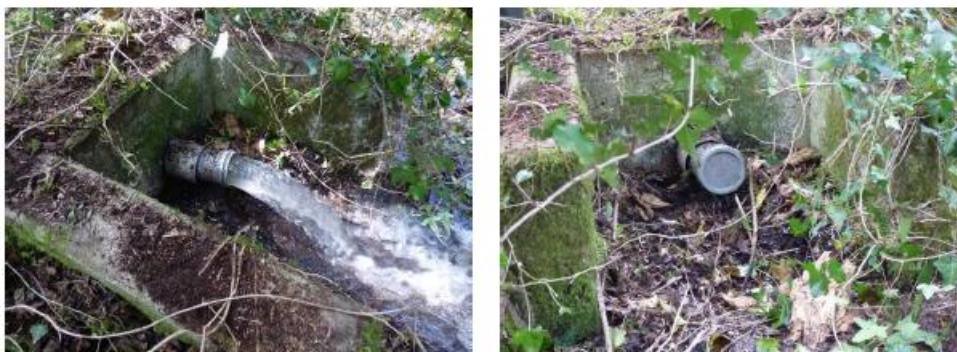
Figure 16 : trop-plein de P2(5) muni d'un bouchon
