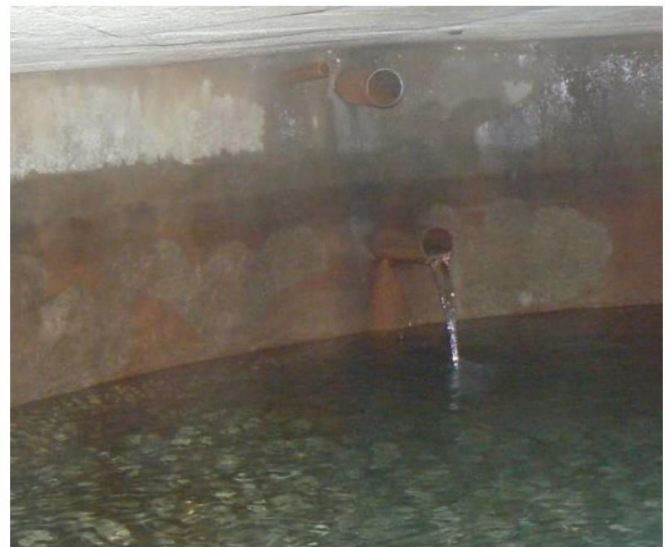
Canalisation d'arrivée de P3 en bas (les deux autres canalisations sont bouchées)
