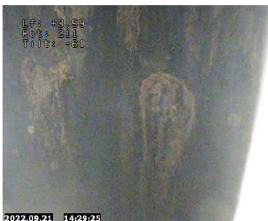
Prof 3.60 m : vue latérale / parois avec dépôts sombres / barbacanes colmatées
