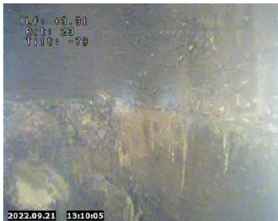
Prof 3.31 m : vue latérale / jonction entre deux buses en béton présentant des dépôts d'hydroxydes de fer
