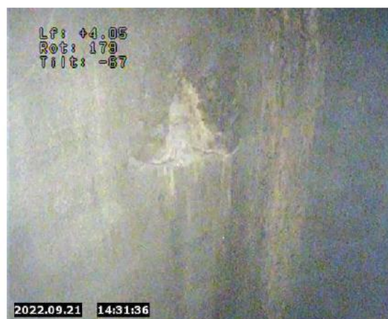
Prof 4.05 m : vue latérale / parois avec dépôts sombres / barbacanes colmatées
