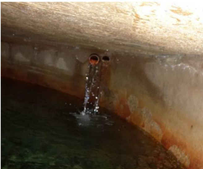
Canalisations d'arrivée de P1 (à droite) et P2 (à gauche)
