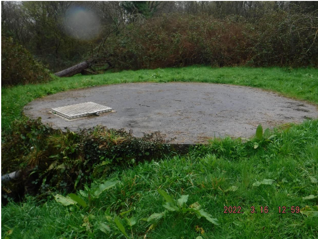
Photo 16 : Bâche d'eau brute
