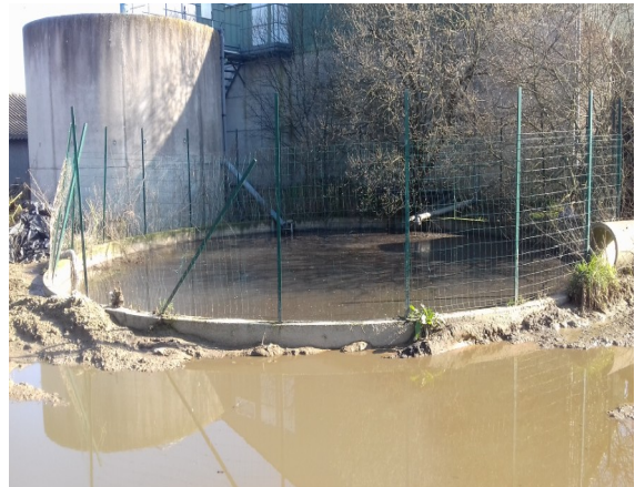
Ouvrage de stockage des déjections défaillant
