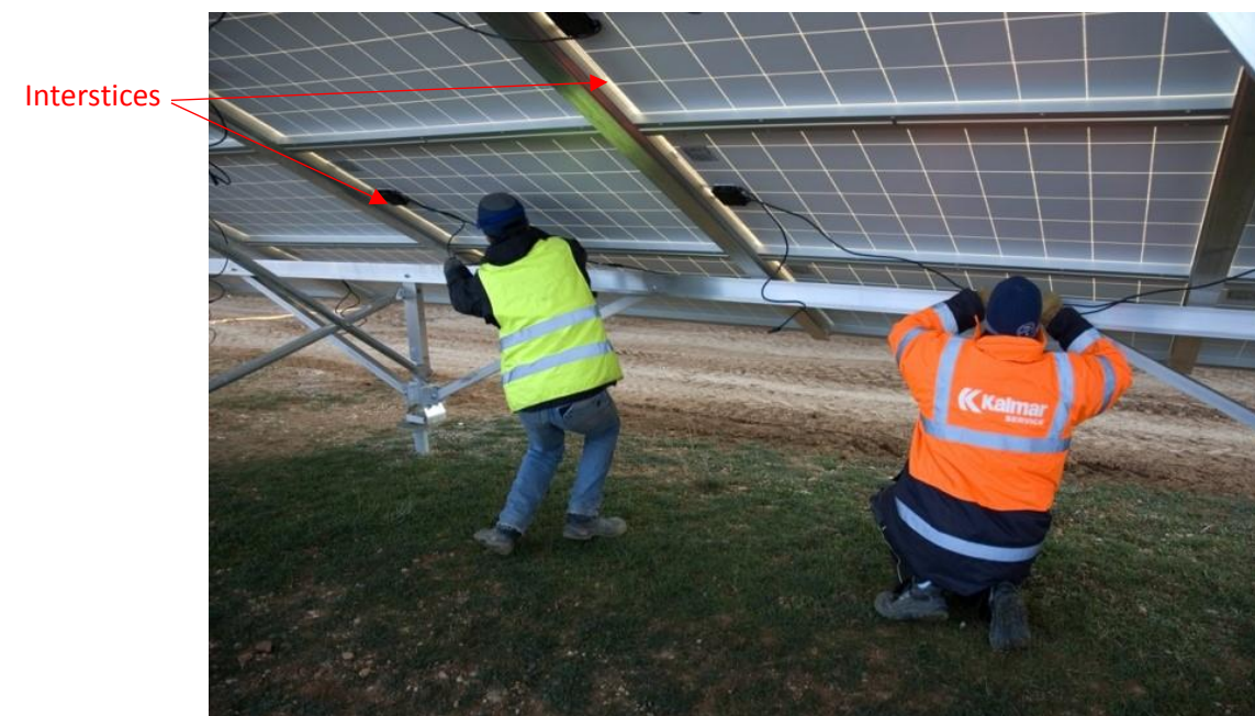
Figure 233 : Vue des interstices entre chaque panneau (IEL Développement)
