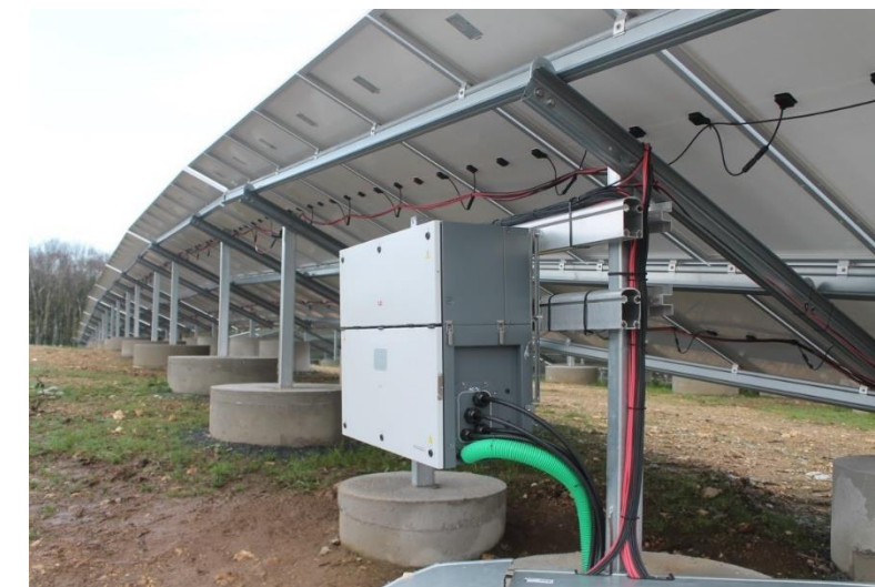
Figure 209 : Photo d'un onduleur d'un projet en phase de construction (FS du Cosquer, ancienne décharge, une réalisation IEL)
