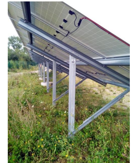
Figure 33 : Câblage intégré aux structures (Bruz)
