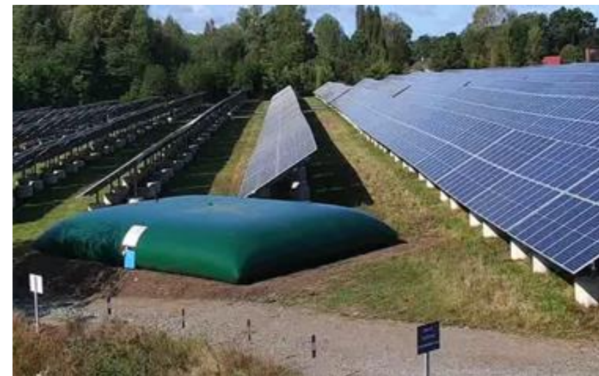
Figure 24 : Citerne incendie 60 m3 de la centrale photovoltaïque au sol du Gravier à Aubigné-Racan (72), une réalisation IEL
