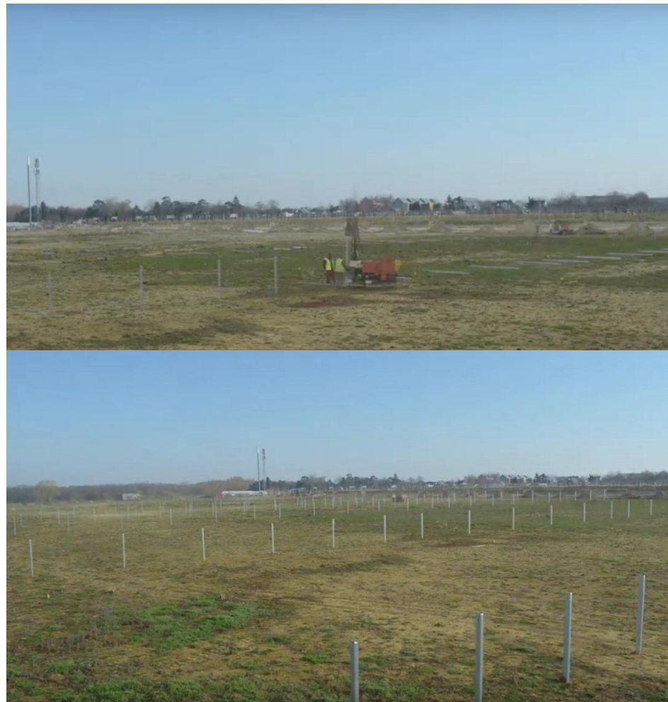
Figure 27 : Mise en place des pieux battus - photos de la construction de la FS Marc Energies, une réalisation IEL
