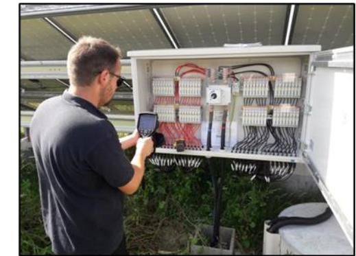
Figure 43 : Actions de maintenance IEL
