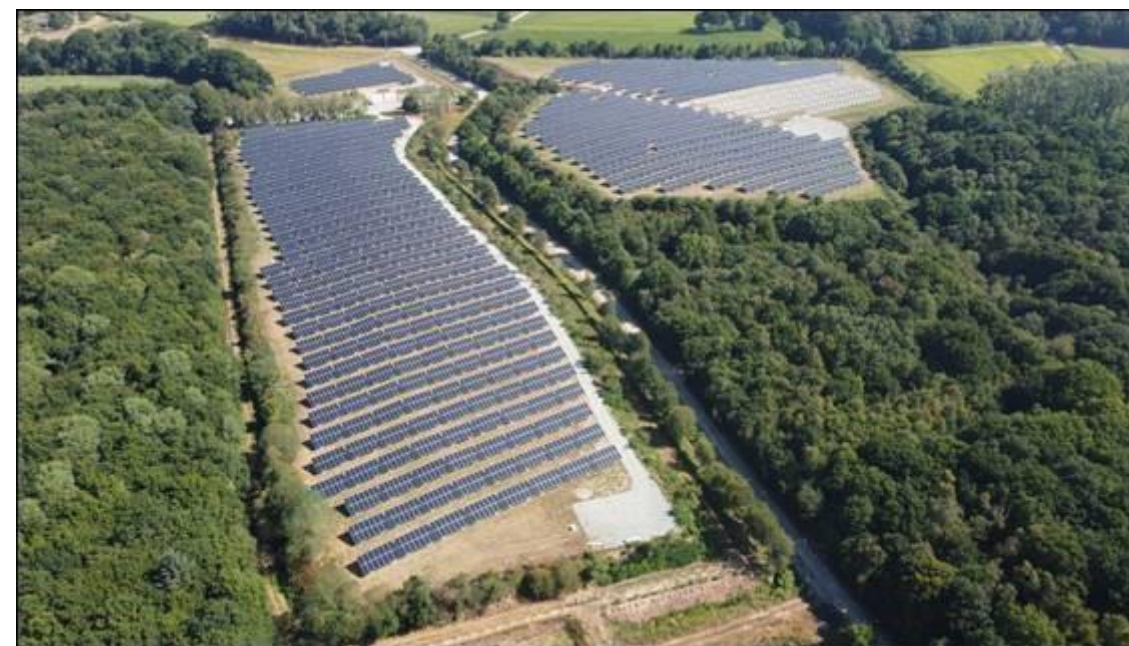
Figure 18 : Centrale photovoltaïque de Ruca, une réalisation IEL (Photo prise en cours de construction)
