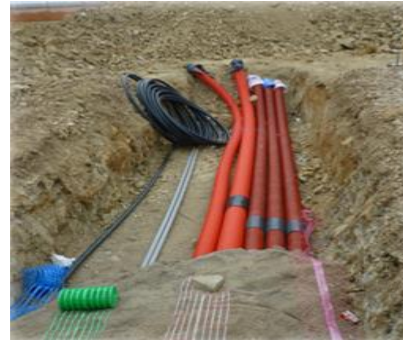
Figure 37 : Câblage sur site entre les postes électriques (source : IEL)
