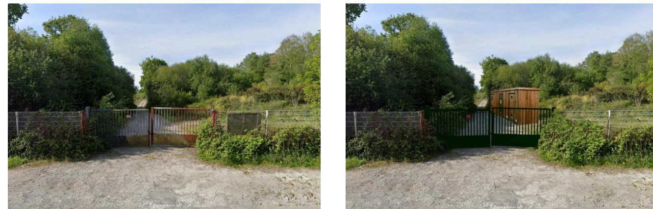
Figure 67 : Entrée du Camp d'Aucaleuc – présence du poste de livraison pour l'injection de l'électricité produite par la centrale photovoltaïque sur le réseau public d'électricité
