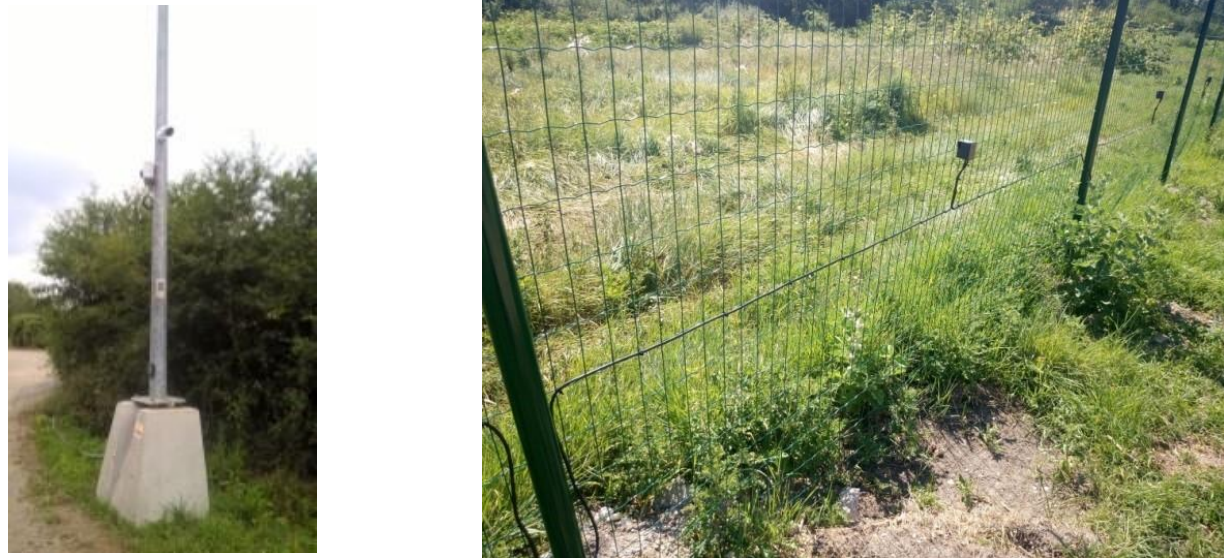
Figure 22 : Système de vidéo-surveillance avec détection infrarouge (à gauche) et du câble de détection (à droite) – photos prises sur les centrales solaires d'IEL à Machecoul (44) et à Descartes (37)
